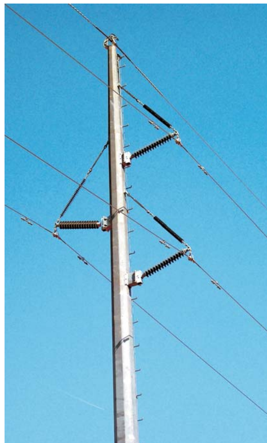
1 x 110kV AlFe 150/25
