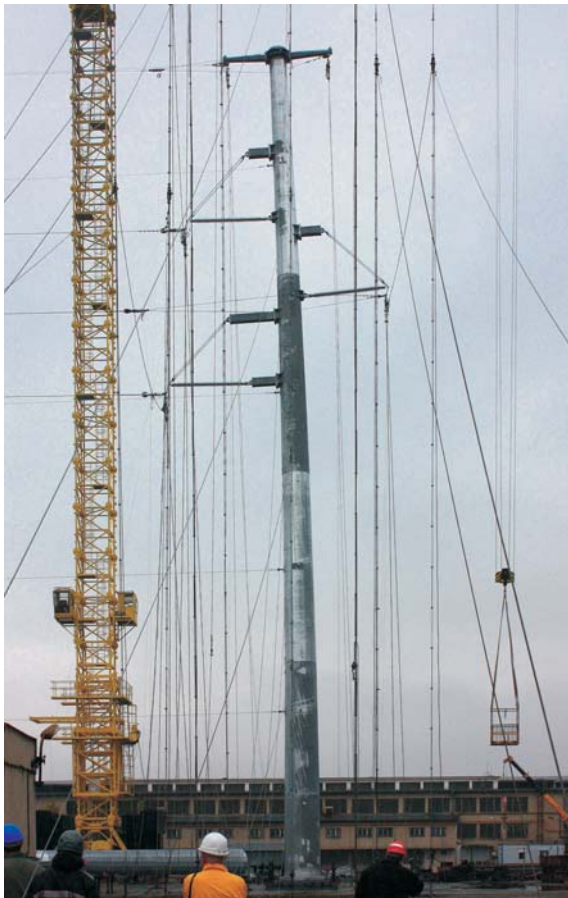
Skúška 1 x 400 kV Žilina (150% zaťaženie)
